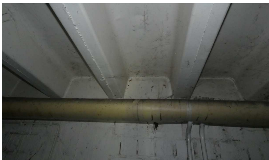
Abb. 25: Beispielbild Leitungsverläufe Kellergeschoss unterhalb entlang Kellerdecke (Quelle: H & P)
