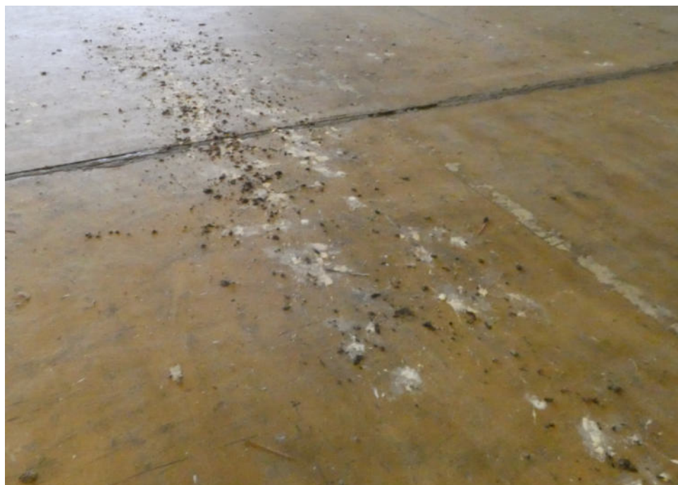
Abb. 29: Kots Spuren im Bereich der nördlichen Hallen unweit einer fehlenden Fensterfront (Quelle: H & P)
