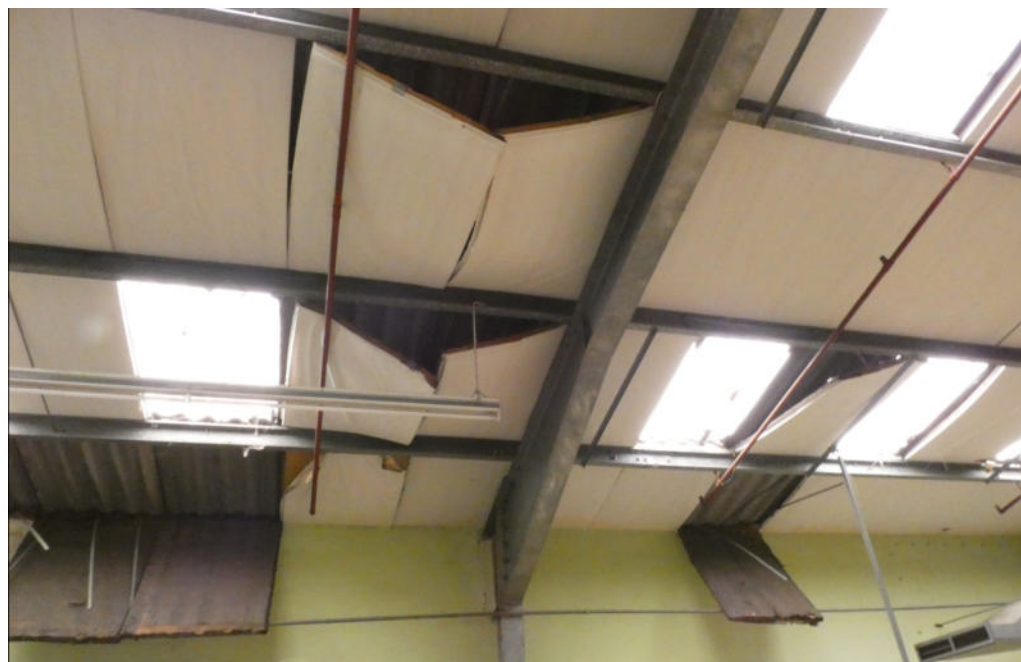
Abb. 22: Potenzielle Quartierstrukturen im Bereich der einschichtigen Dachverkleidung; unter den Dämmplatten sind direkt die Eternitplatten der Dacheindeckung zu erkennen (Beispielbild, Quelle: H & P)
