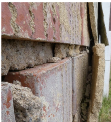
Abb. 21: Potenzielle Spaltenquartiere im Bereich von Putzabplatzungen (beispielhaft; hier am Nordende der südwestlichen Gebäudelängsseite, ca. auf Brusthöhe, Quelle: H & P)
