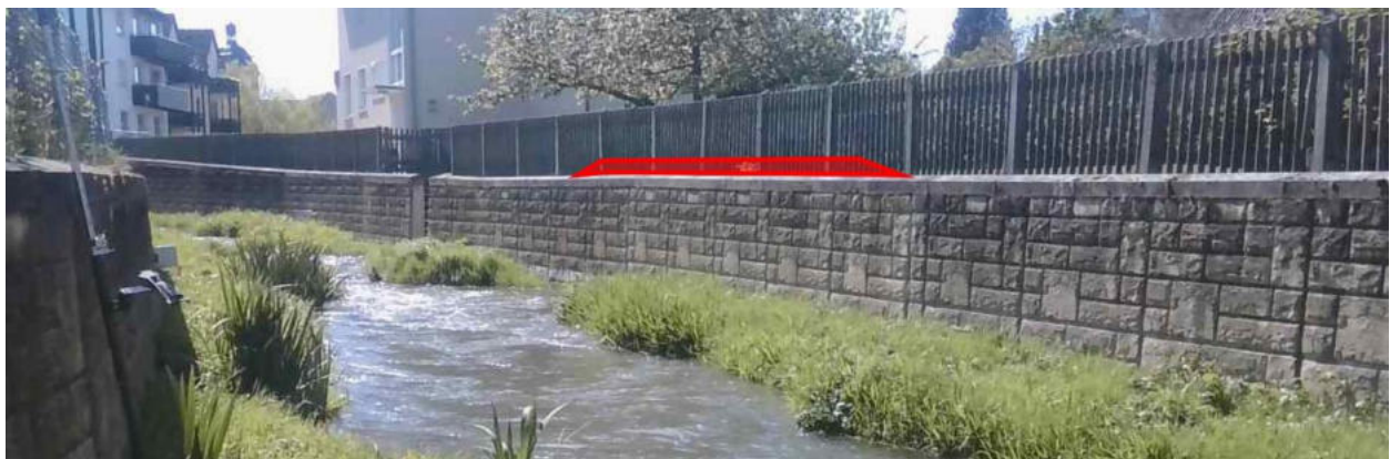
Abbildung 84: Mauererhöhung am Anwesen ,Rotkreuzweg 5‘ (Bereich Goethestraße)
